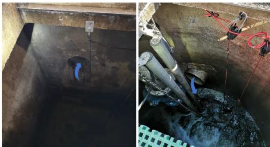
Figure 3-1 : alimentation du trop-plein (à gauche) et rejet (à droite)
